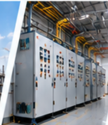
ELECTRICAL INSTALLATIONS التركيبات الكهربائية
